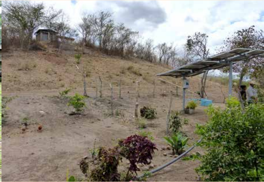
Solaranlage für die Wasseranlage ermöglicht Bewässerung der Gärten und garantiert Trinkwasser.
